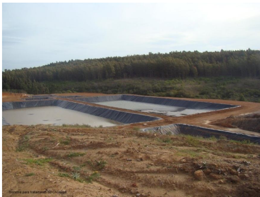
Figura 3.43 – Lagoas de estabilização para tratamento dos lixiviados
