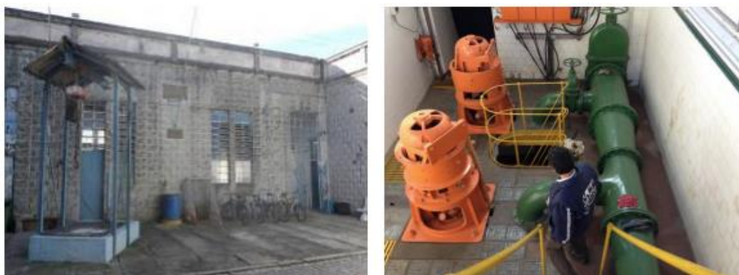
Figura 220 – EEE US-I – Estação Elevatória US-1. Fonte: PDE, 2011
