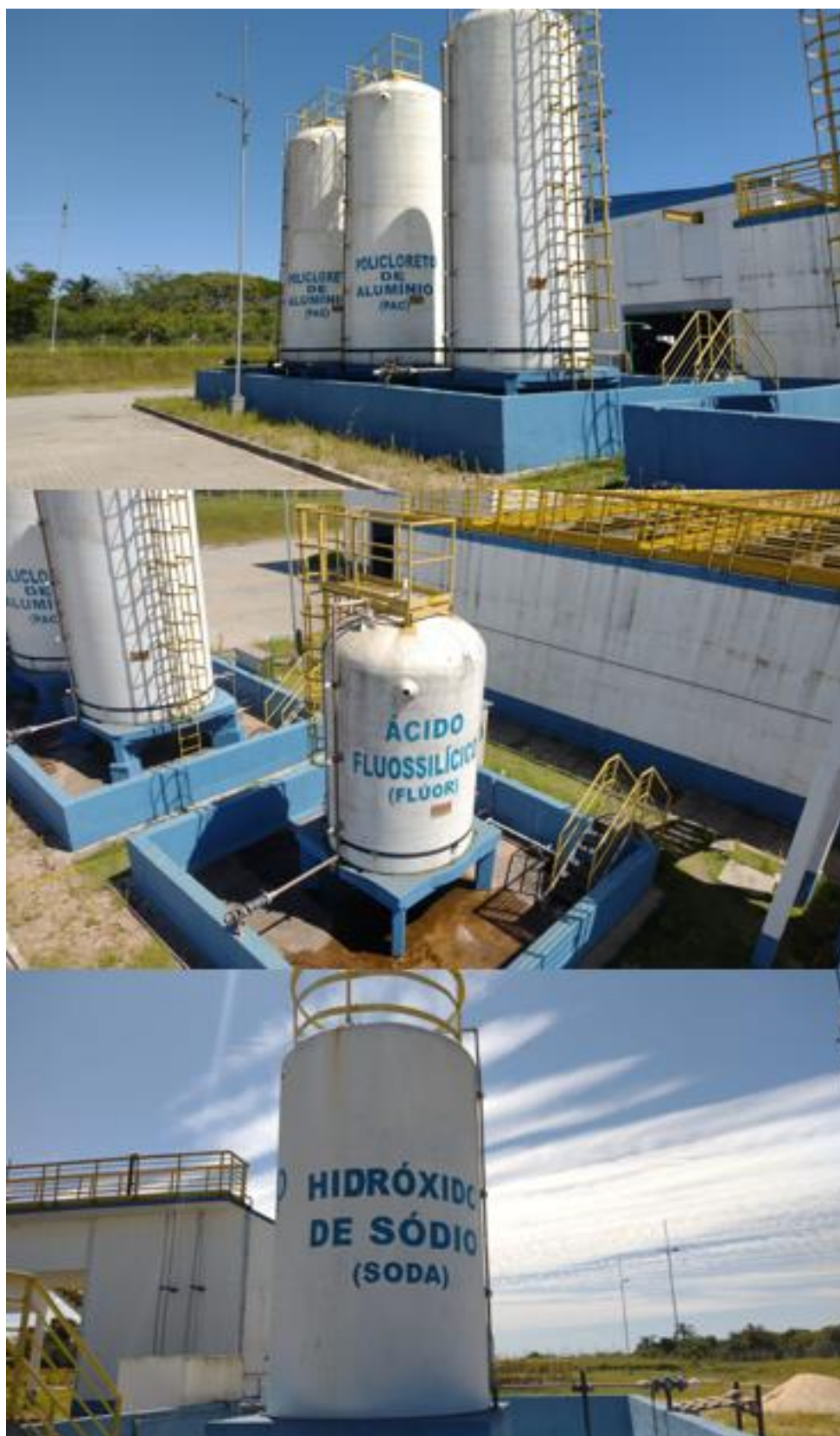
Figura 75 – Tanques ETA São Gonçalo-18. Fonte: Biancade Engenharia
