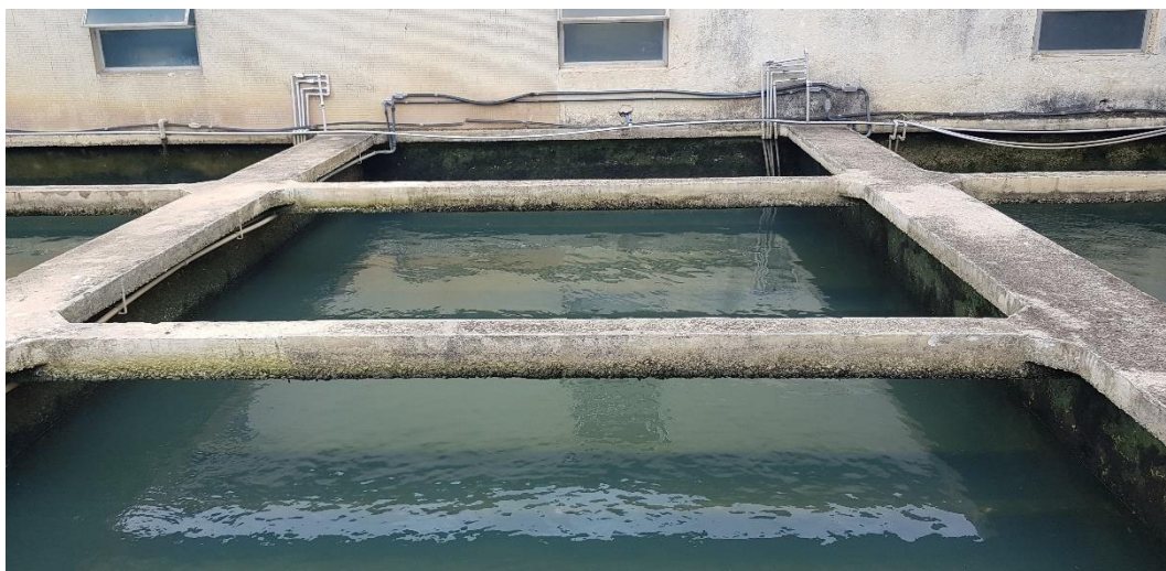
Figura 47 – Filtros de Areia. Fonte: Biancade Engenharia
