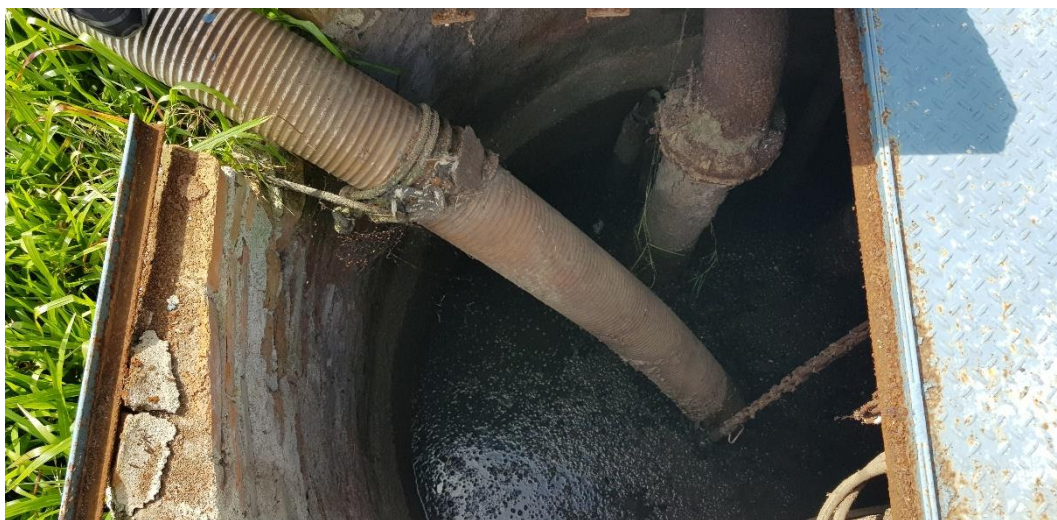
Figura 197 – EEE Rodoviária – Poço de Sucção. Fonte: PDE, 2011
