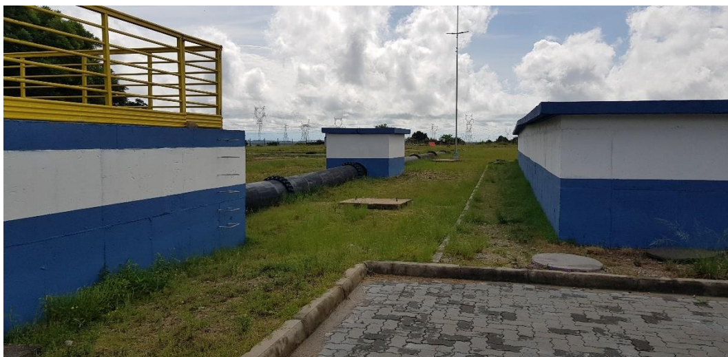
Figura 72 – Adutora de Água tratada. Fonte: Biancade Engenharia
