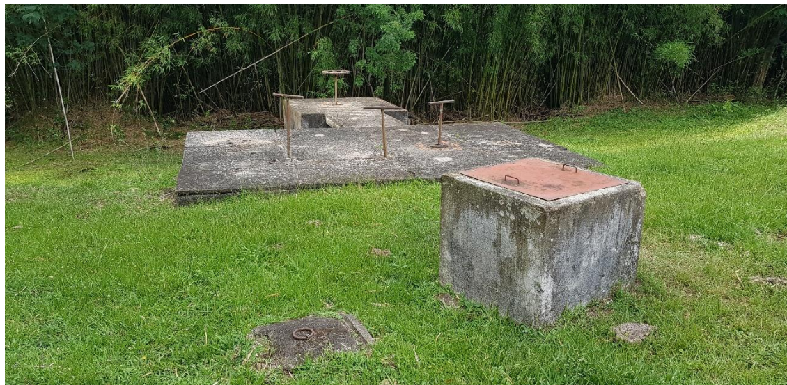
Figura 83 – Caixa de Inspeção. Fonte: Biancade Engenharia
