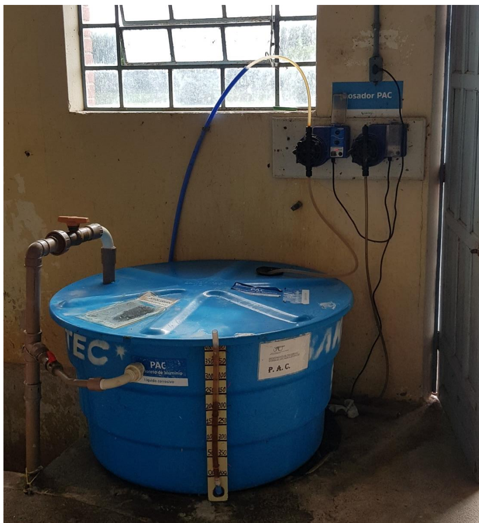
Figura 32 – Caixa Dosadora de PAC. Fonte: Biancade Engenharia
