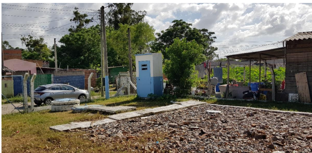
Figura 198 – EEE Ceval – Estação Elevatória Ceval. Fonte: PDE, 2011
