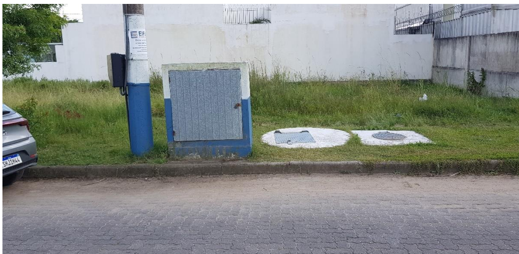
Figura 205 – Estação Elevatória Visconde da Graça. Fonte: PDE, 2011
