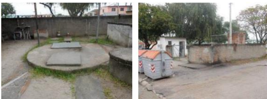
Figura 214 – EEE Guabiroba – Estação Elevatória Guabiroba. Fonte: PDE, 2011
