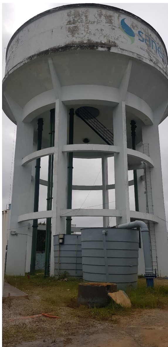
Figura 126 – Reservatório R-15T do Município. Fonte: Biancade Engenharia
