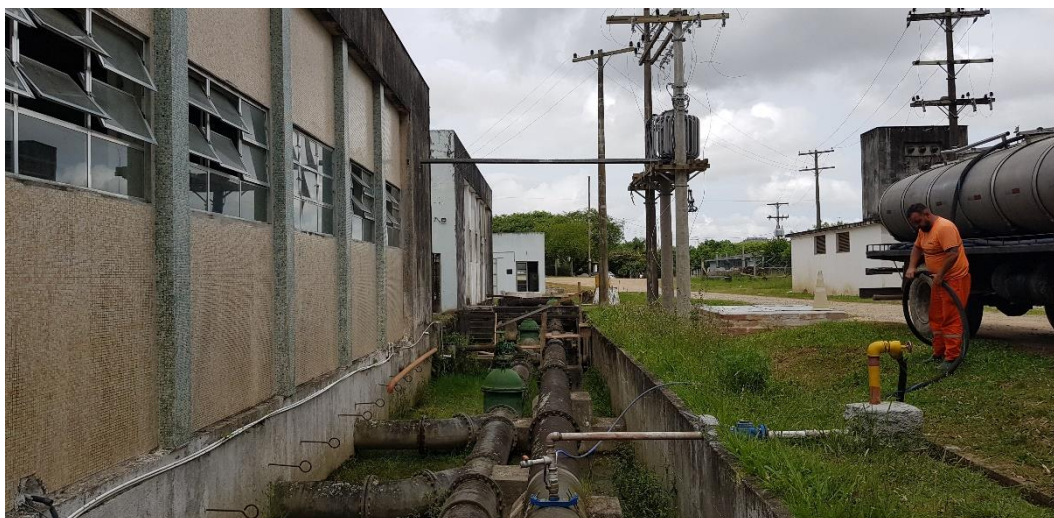
Figura 92 – Adutoras de Água Tratada. Fonte: Biancade Engenharia
