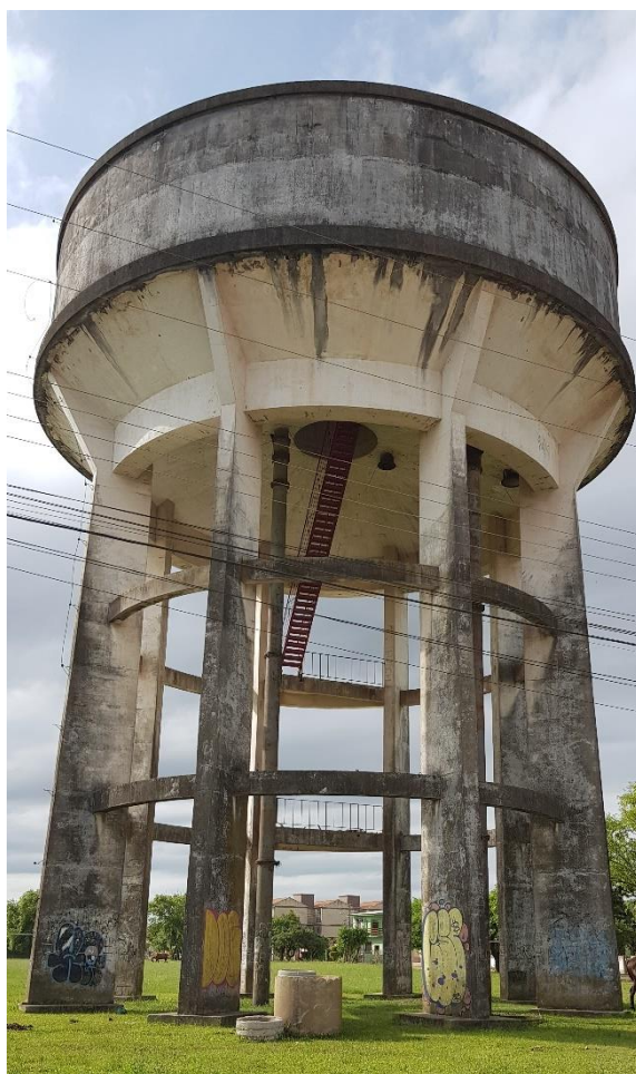
Figura 122 – Reservatório R-10T do Município. Fonte: Biancade Engenharia
