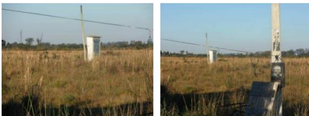
Figura 216 – EEE Espanha – Estação Elevatória Espanha. Fonte: PDE, 2011
