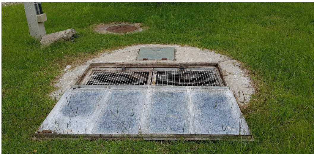
Figura 202 – Estação Elevatória Vila Bela. Fonte: PDE, 2011
