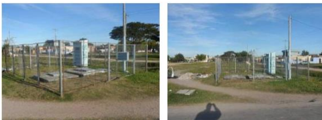
Figura 206 – EEE Meneguetti – Estação Elevatória Meneghetti. Fonte: PDE, 2011
