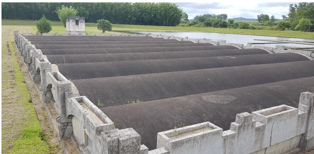
Figura 40 – Reservatório ETA Moreira. Fonte: Biancade Engenharia
