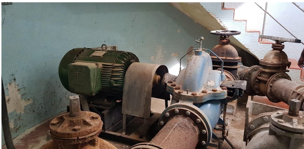
Figura 103 – Bomba da EEAT 3. Fonte: Biancade Engenharia
