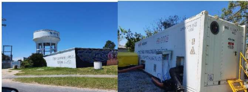
Figuras 17 e 18. Entrada do local e ETA Móvel, respectivamente.
